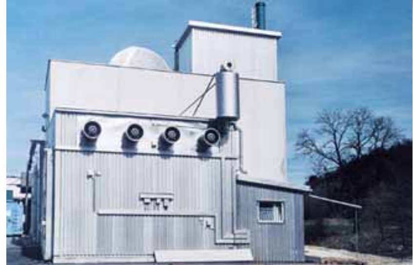
Anlage der Firma: Mühlböck (Österreich) mehrstufiges Verfahren
